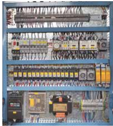
Zuverlässigkeit durch hochwertige Elektrokomponenten
